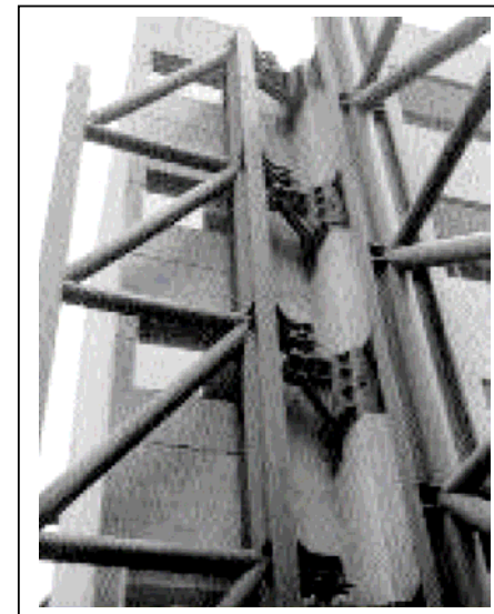
Fotografía 3.8 Reforzamiento por disipadores de energía En el Hospital Centro Médico Nacional Siglo XXI)
