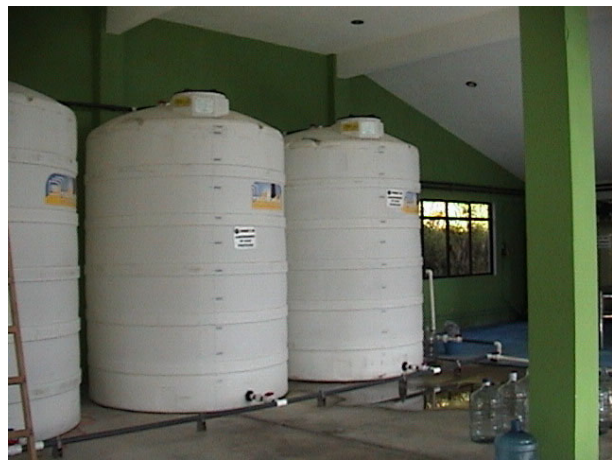
CILINDROS DE ALMACENAMIENTO DE AGUA
