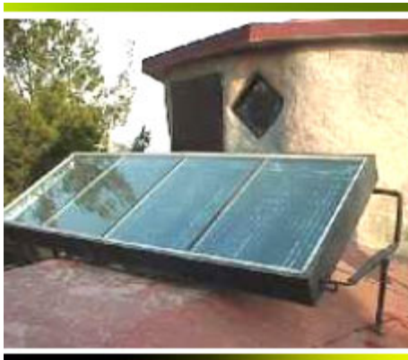
Fig. 33 Calentador solar de agua
