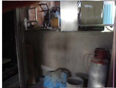
Instalación de gas LP de servicio para el secador de pintura
