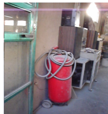
Vista del exterior, justo en la entrada al área de pintura. Se observa la localización del extintor.
