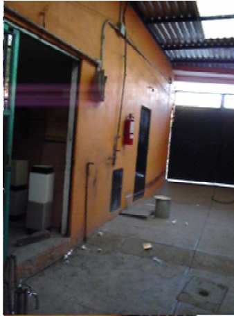
Vista general del patio. Se observa extintor y el área despejada.
