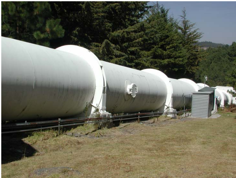
Fig. 8 Ducto en el cual es enviada el agua potable a la ciudad de México.
