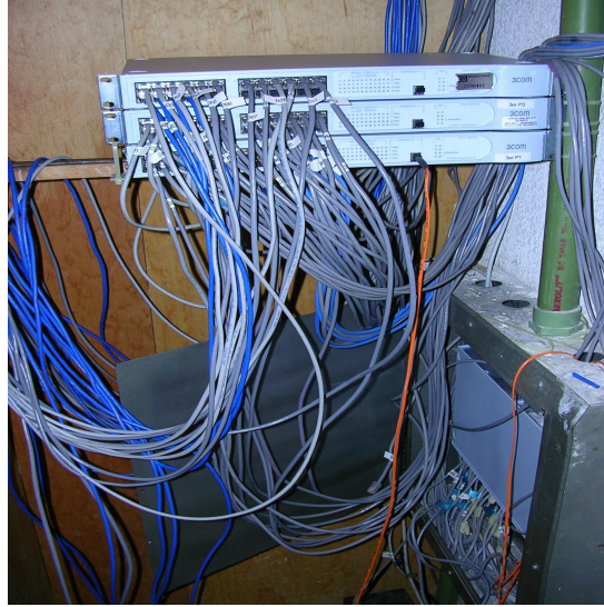
Segundo Piso. Switch atornillado dentro de un registro de metal, cableado en desorden, un switch mas sobrepuesto en la pared.
