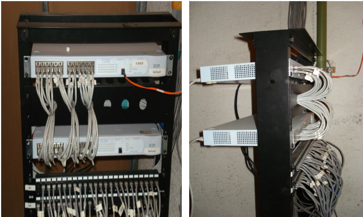
Figura 4.4. Armario de telecomunicaciones en 2do Piso, Universum
