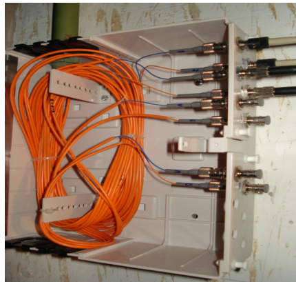
Figura 4.3. LIU instalado en el cuarto de equipo en Universum
