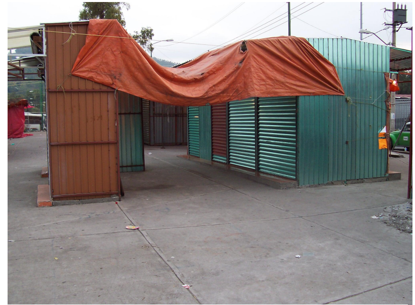
Abandono de locales comerciales en el cuerpo 2 del Cetram Fuente: Acervo Fotográfico personal.
