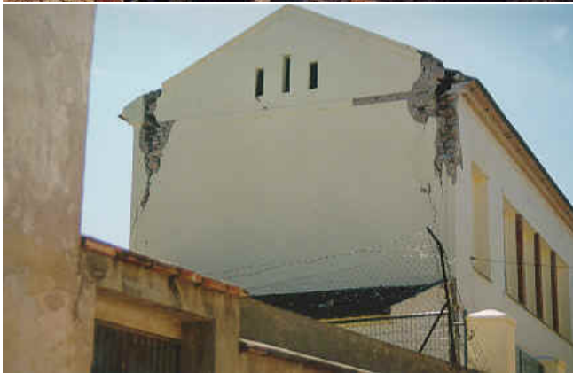
Figura III.III (C) La imagen presenta daños en estructura debido al sismo ocurrido en la ciudad de Manzanillo, Colima en el año de 1995.
