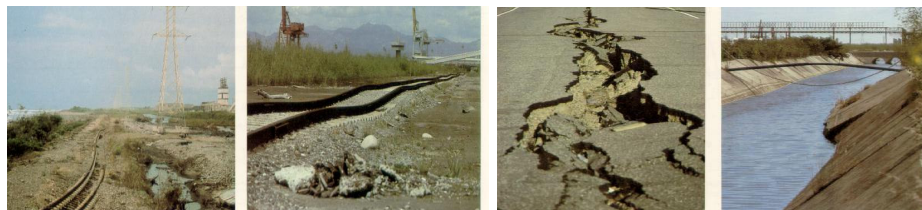
Daños y agrietamientos por movimientos sísmicos.
