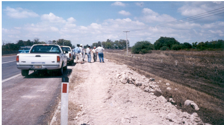
Figura III.I Reunión técnica para evaluación de deslave en hombro de terraplén cpo. Derecho, autopista Querétaro-Irapuato
