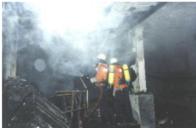
Figura III.VIII Daños del PVC por causa del incendio
