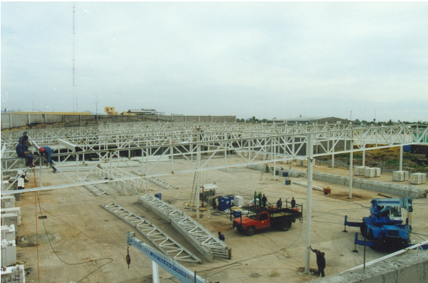
Figura II.1' Vista de la construcción de una nave industrial a base de estructura metálica
