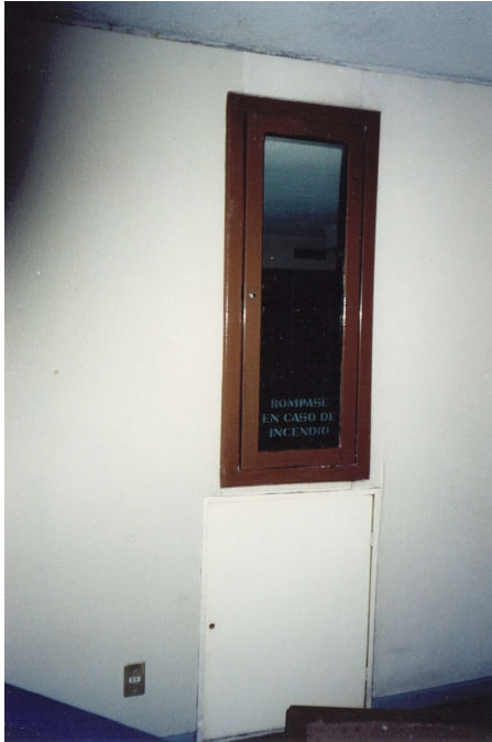
Figura II.IV Vista de un extintor contra incendio
