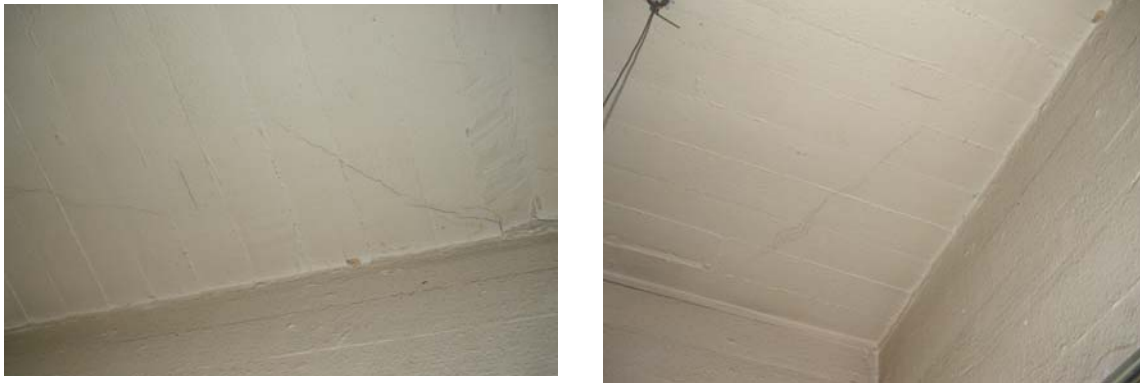
Figura 2.7 Detalle de agrietamiento en losa maciza de concreto
