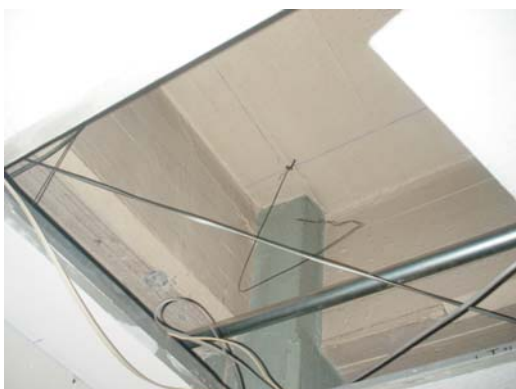
Figura 2.5 Detalle de agrietamiento en traveses en nudo
