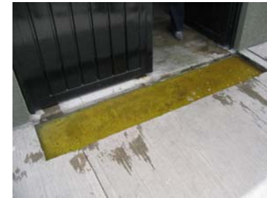
Tapete sanitario en accesos
