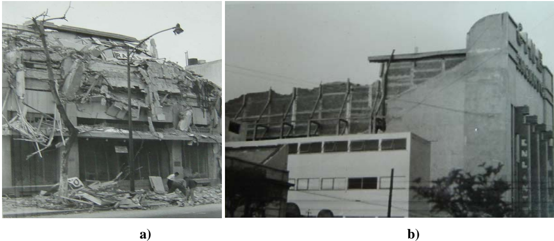
Figura 2.6 Colapsos parciales: a) edificio en Insurgentes # 377, sólo la planta baja quedó en pie y b) Cine Encanto que perdió el techo y parte de los muros.
