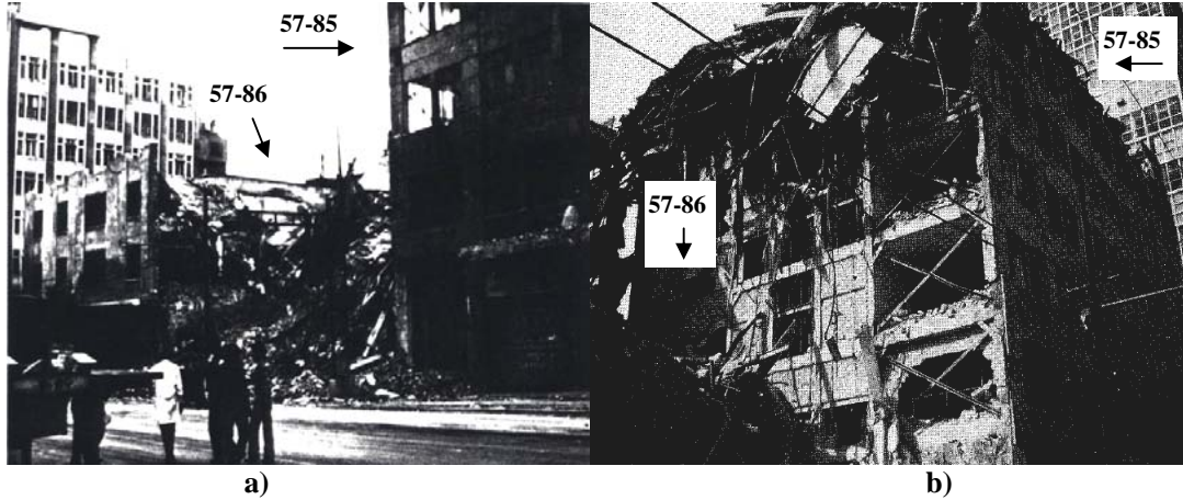
Figura 4.7 Ejemplo de daños por golpeteo durante el sismo del 19/09/85, a) estructura 57-86 sufrió colapso total al ser aplastada por los niveles superiores del edificio vecino, b) estructura 57-85 sufrió colapso parcial de los 5 niveles superiores, zona donde coincidía con el último piso del edificio vecino.
