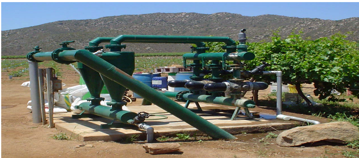
Figura 3.18 Valle de Guadalupe: sistema para bombeo de agua del subsuelo
