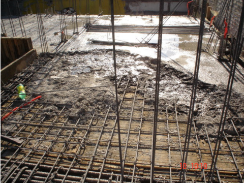
Colado interrumpido por inconsistencias en el armado
