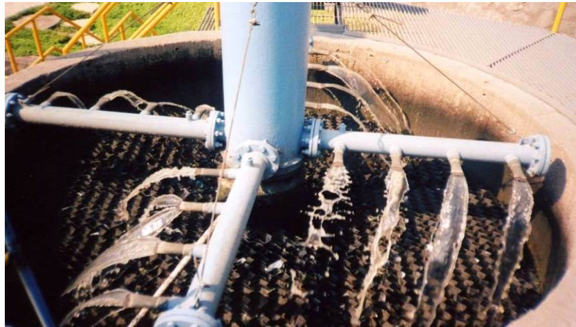
Figura 3. Filtro Percolador de la planta de tratamiento de Ciudad Universitaria
