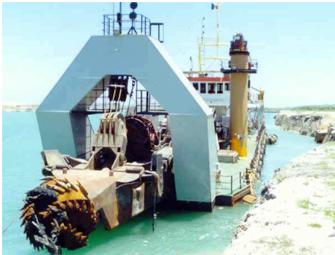
Draga Mercurius en labores de dragado de construcción en el puerto de Altamira, Tams., en 2002.
