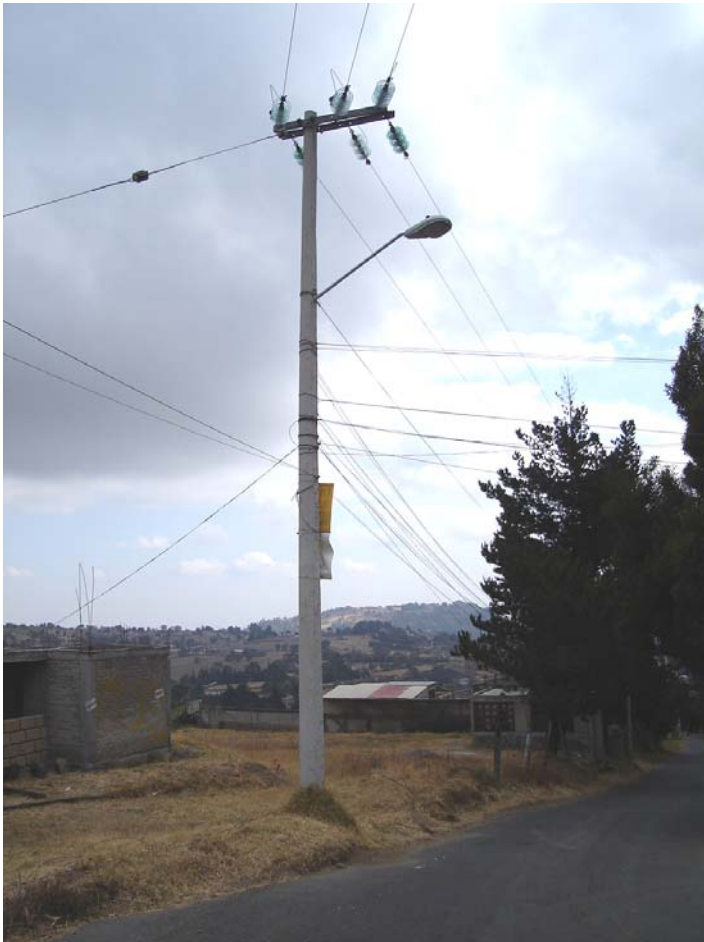
Foto 3. Cableado de luz
