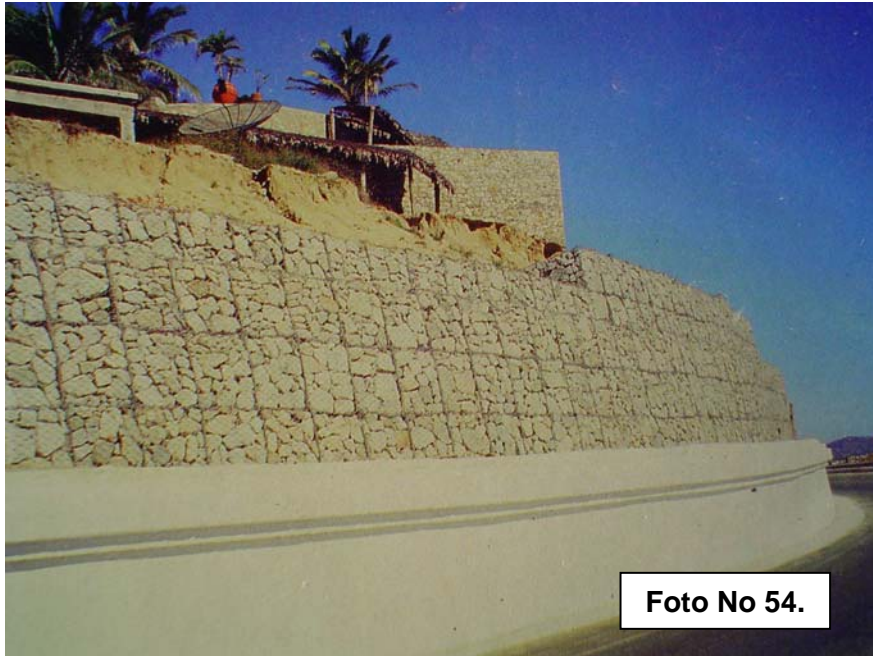
Foto No 54.- Aquí se muestran los muros gabión ahora utilizados como un sistema de contención de un talud.
