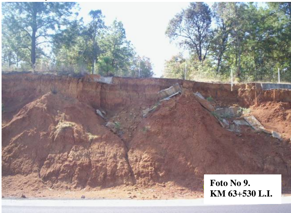
Foto No. 9.- La foto muestra una zona del talud que está seriamente dañado, la contracuneta se colapsó debido al derrumbe de material donde se apoyaba, esto provoca que se formen pequeñas barranquillas por donde escurre el agua, así aumentando la erosión del talud y generando "caídos".
