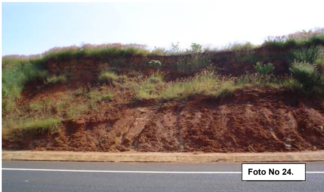
Foto No 24.- Vista de uno de los taludes del tramo del Km. 62 +000 al Km. 64+000, se observa como el flujo de agua, deforma el talud, y forma líneas de flujos de lodos, deslizando parte del suelo del talud hacia abajo, formando un escalón donde los limos más consolidados no le permiten pasar a través de ellos. (Fuente: Propia)
