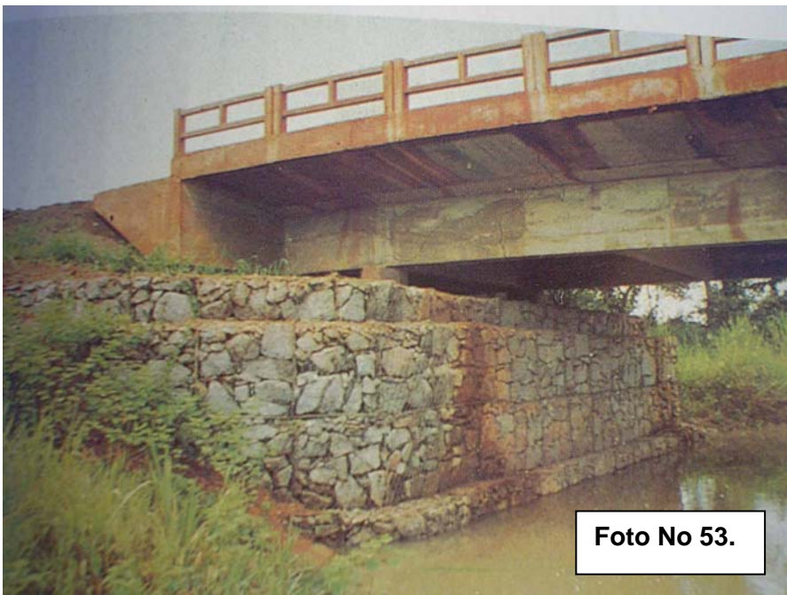
Foto No 53.- Se muestra la utilización de los muros gavión como cono de derrame en un puente para evitar la socavación.
