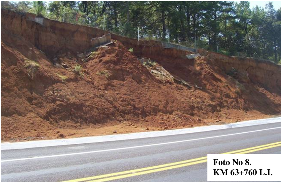
Foto No 8.- La fotografía está mostrando el talud que se localiza entre los Km. 63+720 al Km. 63+890. Como en la foto anterior se observa la contracuneta totalmente colapsada y además, también se presenta el problema de la invasión de propiedad privada.
