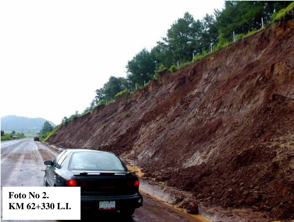
Foto No 2.- La foto está mostrando el talud que se localiza entre los Km. 62+280 al Km. 62+370. Del camino directo, se pueden observar los “caídos” que están depositados en la base del talud.
