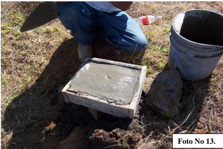
Foto No 13.- Elaboración de mojoneras de concreto, para la fijación de los bancos de nivel.
