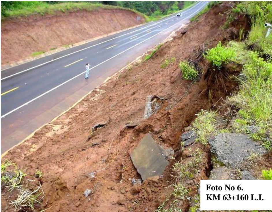
Foto No 6.- Talud ubicado entre los Km.63+160 al Km. 63+360. Esta imagen muestra claramente como la contracuneta ha desaparecido, y los daños que se han presentado a los terrenos de los particulares.
