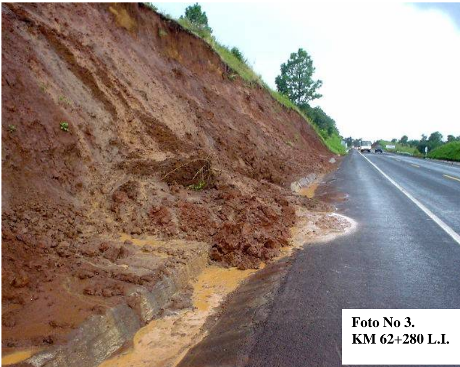
Foto No 3.- Este talud es el que se localiza entre los Km. 62+530 al Km. 62+640. Se puede mirar que los derrumbes están sobre la cuneta, lo cual está provocando la obstrucción del escurrimiento del agua, la cual no puede ser desalojada adecuadamente.
