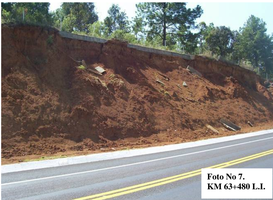
Foto No 7.- El talud que se ubica entre los Km. 63+460 al Km. 63+590, su contracuneta está totalmente destruida debido a la inestabilidad del corte, además se alcanza apreciar que el derecho de vía ya paso de sus linderos, afectando a particulares.
