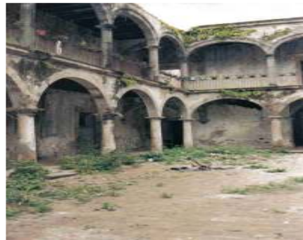
F.1, F.2. Estado actual de la Hacienda de Miravalle
