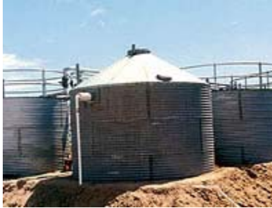
Foto 37. Tanques de la planta de tratamiento
