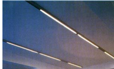
Macroline 160 23W Locales: Lobby
