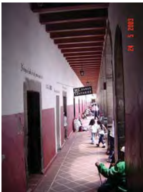
IMAGEN 60.-CORREDOR DE LAS HOSPEDERÍAS CONTIGUAS AL ATRIO, EN ESTE ESPACIO SE LES PERMITE A LOS PEREGRINOS, COCINAR SUS ALIMENTOS, DETERIORANDO PROFUNDAMENTE EL EDIFICIO.
