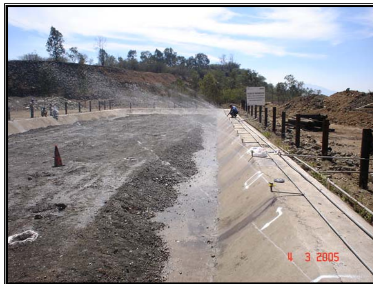
Figura 53. Sistema de irrigación colocado encima del bordo perimetral. Pruebas realizadas con agua.
