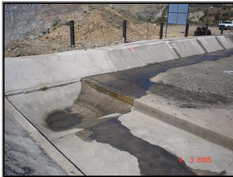
Figura 51. Salida del lixiviado por la canaleta hacia el tanque de almacenamiento
