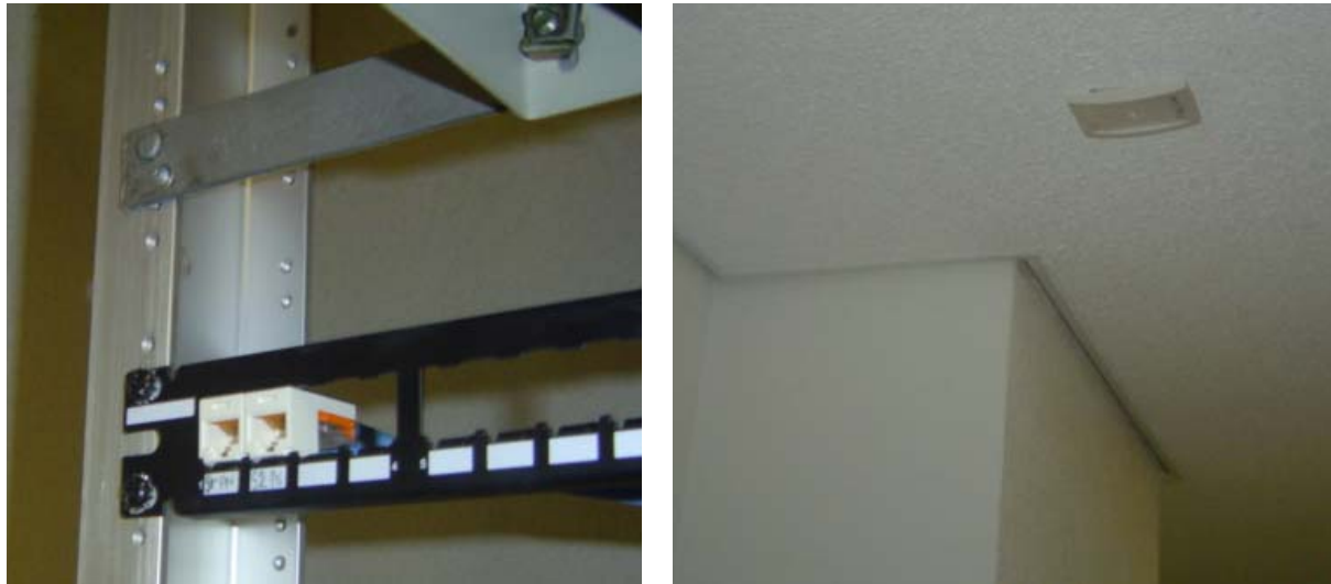
Figura 4.1 Nodos y faceplate para los puntos de acceso de la RIU.
