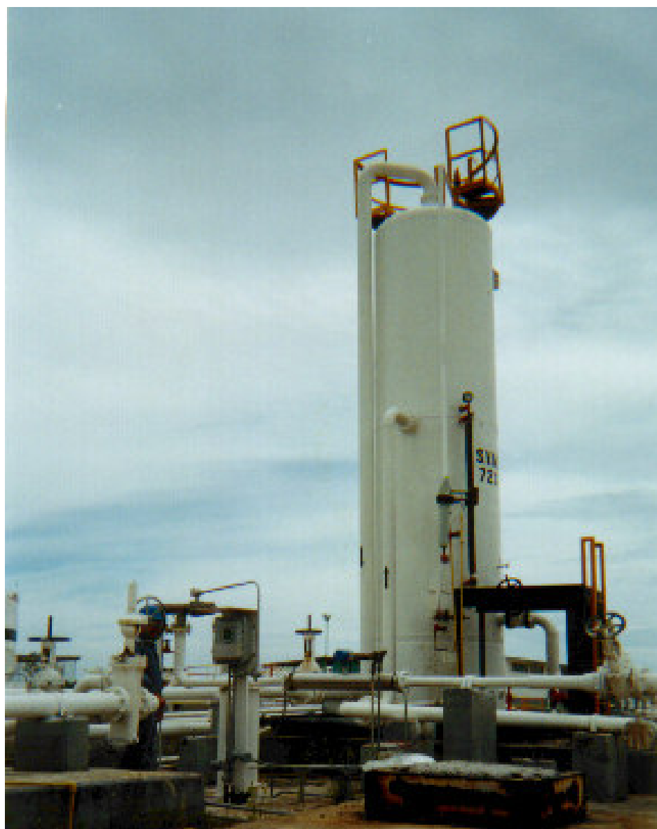
Figura III.4.- Separador bifásico de prueba en la batería 2 del campo Samaria en la Región Sur.
