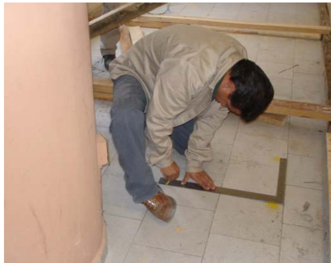
Fotografía 7. Trazo del cajón donde está proyectada la trabe TC-1 para su anclaje a losa existente dentro de las instalaciones del edificio “B”.
