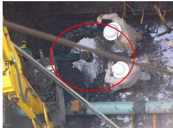
Fotografía 13. Colocación de bomba para abatir el nivel de aguas freáticas, edificio “B”.
