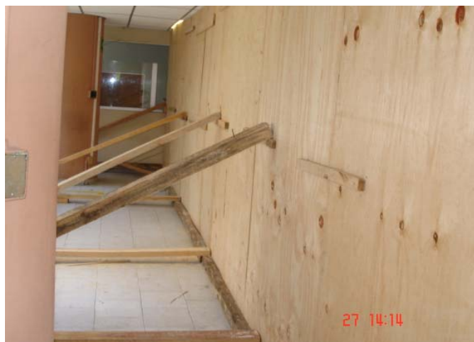
Fotografía 5. Protección de las instalaciones del departamento de Inspección, realizada con tapias a base de hojas de triplay y polines, ubicadas en el interior del primer nivel del edificio “B”.
