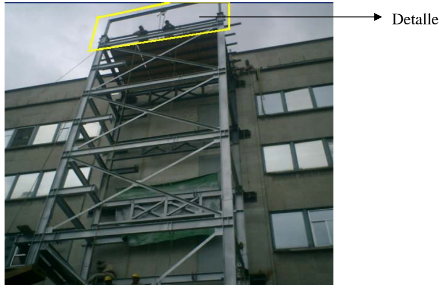
Fotografía 43. El detalle encierra el montaje de los elementos que componen el nivel de azotea, también se puede apreciar la aplicación del primer en la estructura.
