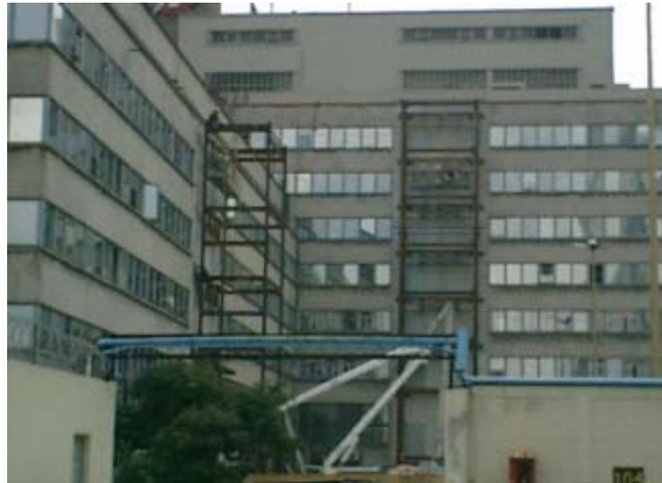
Fotografía 38. Vista de las torres de escaleras, después de realizado el montaje de traveses.
