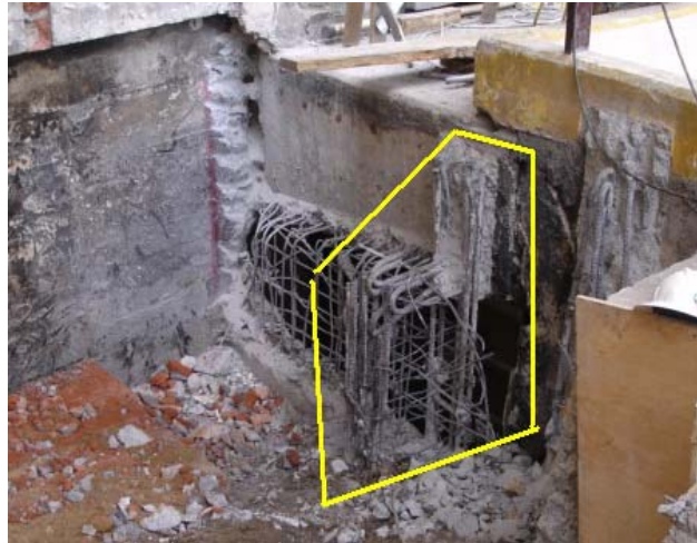
Fotografía 16. El polígono encierra al elemento estructural dañado durante la demolición.
