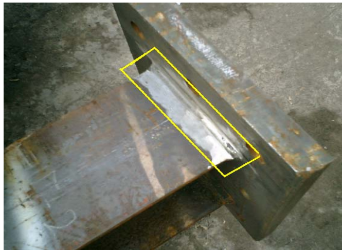
Fotografía 36. Corrección de falta de fusión en cordón de soldadura de placa base de columna.
