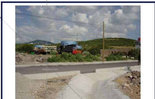
FOTOGRAFIA 20: VISTA DEL CANAL PARA AGUA PLUVIAL Y DEL POSTE PARA LINEAS TELEFONICAS
