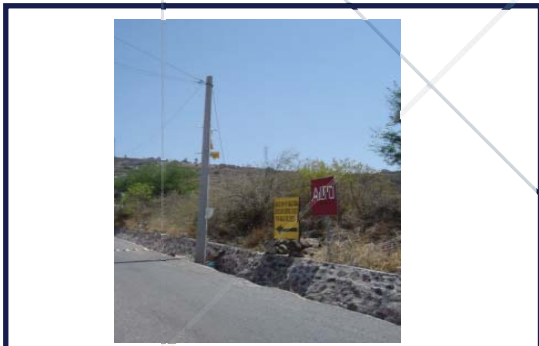
FOTOGRAFIA 22: VISTA DEL POSTE Y CABLES DE LUZ
