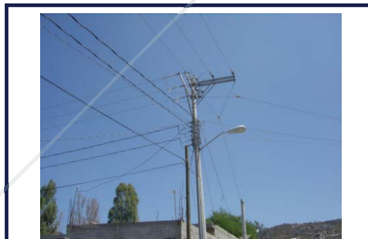
FOTOGRAFIA 21: VISTA DE LINEAS TELEFONICAS, ALUMBRADO PUBLICO Y CABLES DE LUZ
