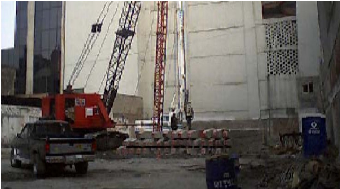
En la Fig. 2.8. Se muestra la fotografía del hincado de los pilotes utilizados.
