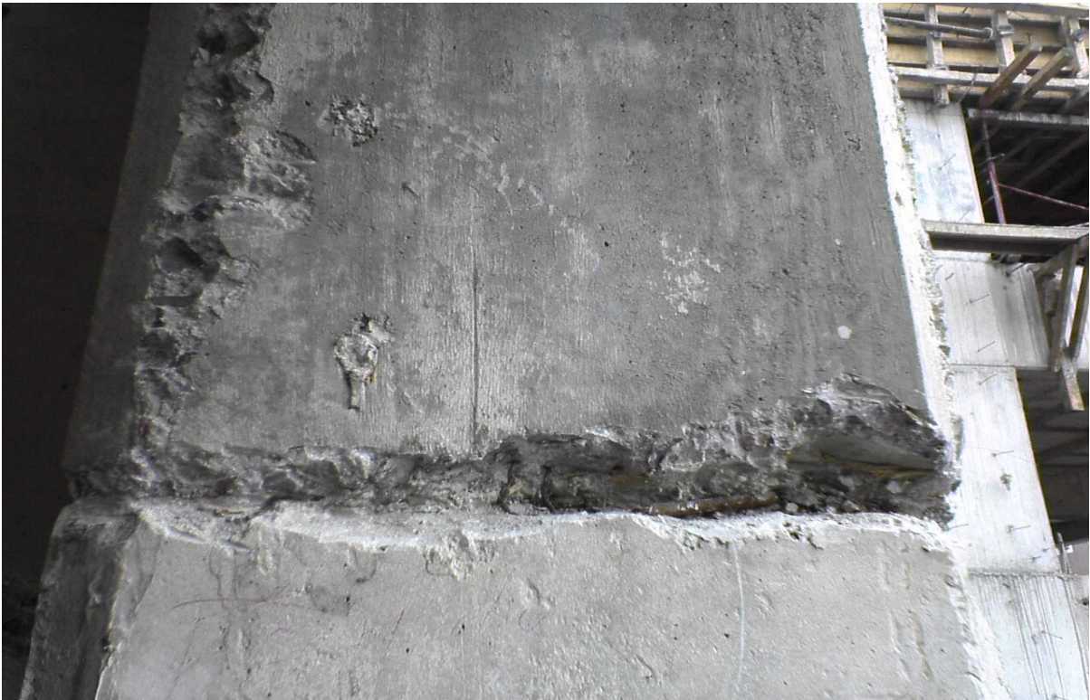
En la Fig. 4.2 Se muestra columna mal colada la cual debe demolerse.
