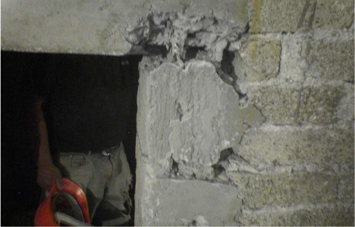
En la Fig. 4.1 Se muestra un defecto común que debe corregirse en la mano de obra (albañilería)
