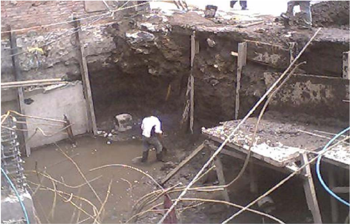
En la Fig. 2.12. Se muestra la forma en que se excavó en algunas secciones del terreno.
