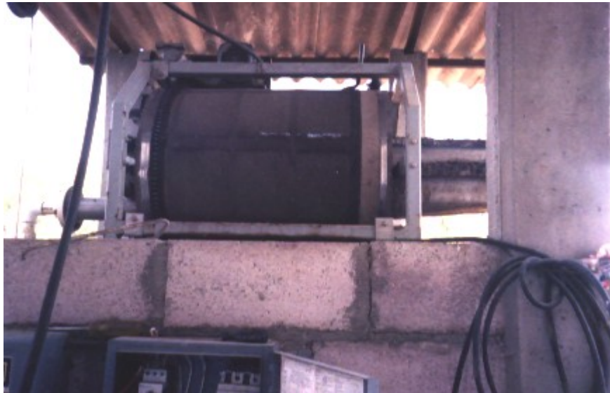
Figura 3. Separador de sólidos
