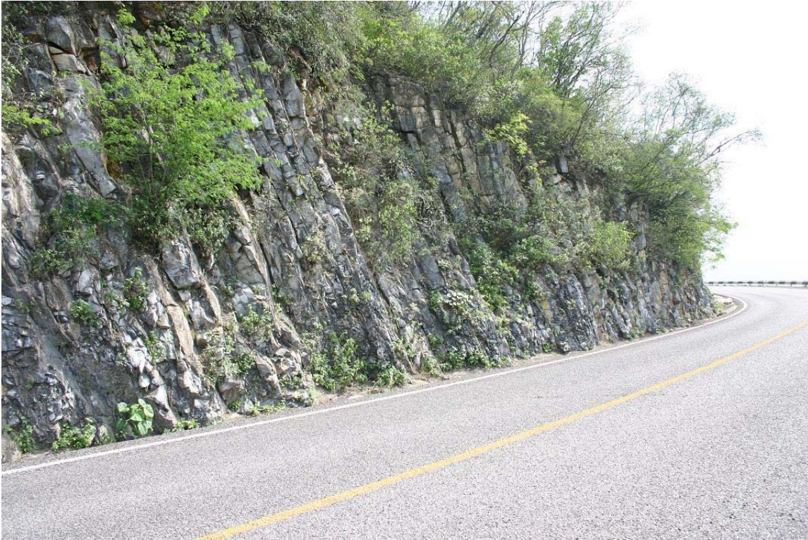
Fotografía 5. Dirección de las juntas propicia para el deslizamiento de fragmentos rocosos.
