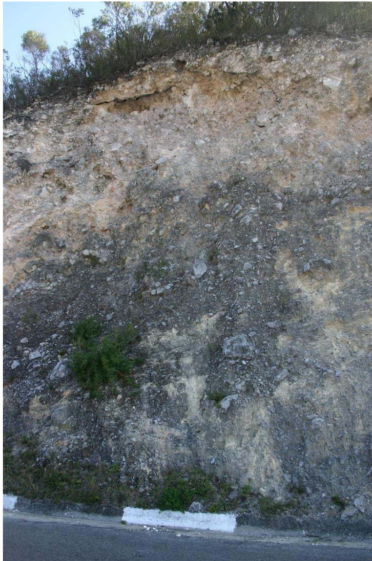
Fotografía 3. Composición de los taludes por estratos de suelo poco cohesivo y fragmentos de roca erosionada.
