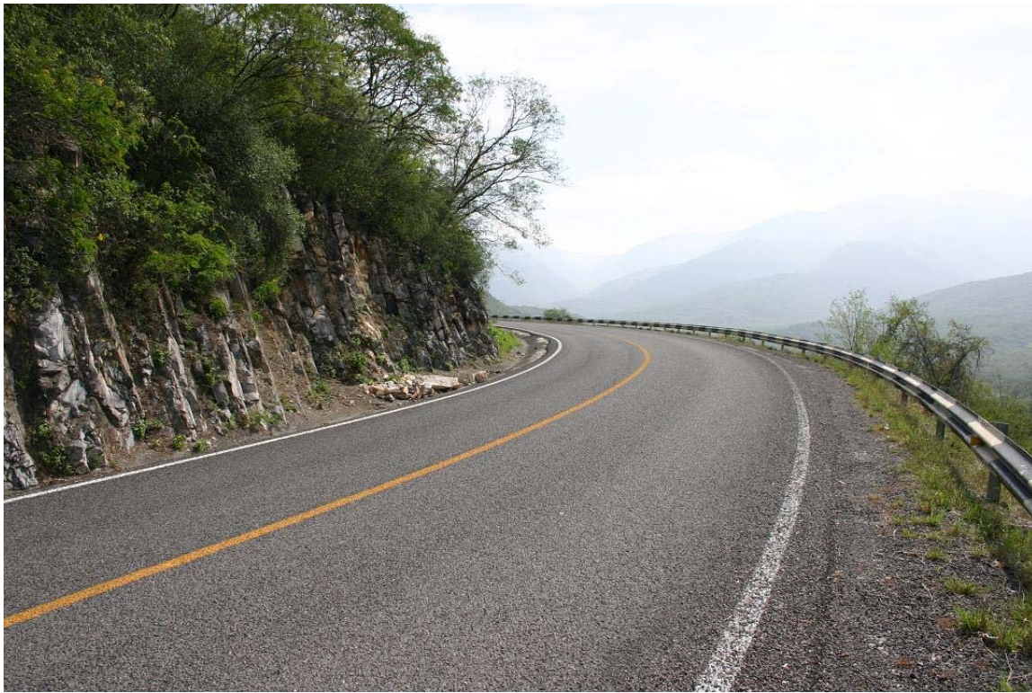
Fotografía 8. Sobreesfuerzos por vegetación sin control.
