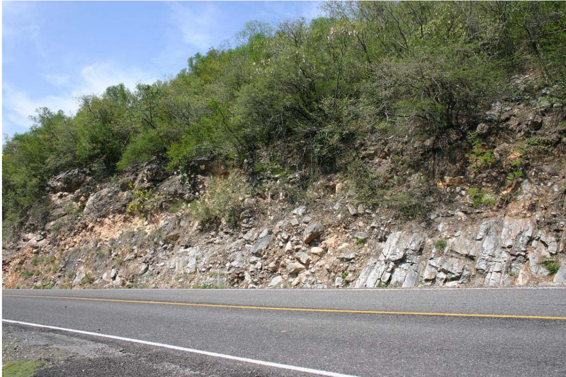
Fotografía 4. Composición de los taludes por estratos de suelo poco cohesivo y muy fragmentado.
