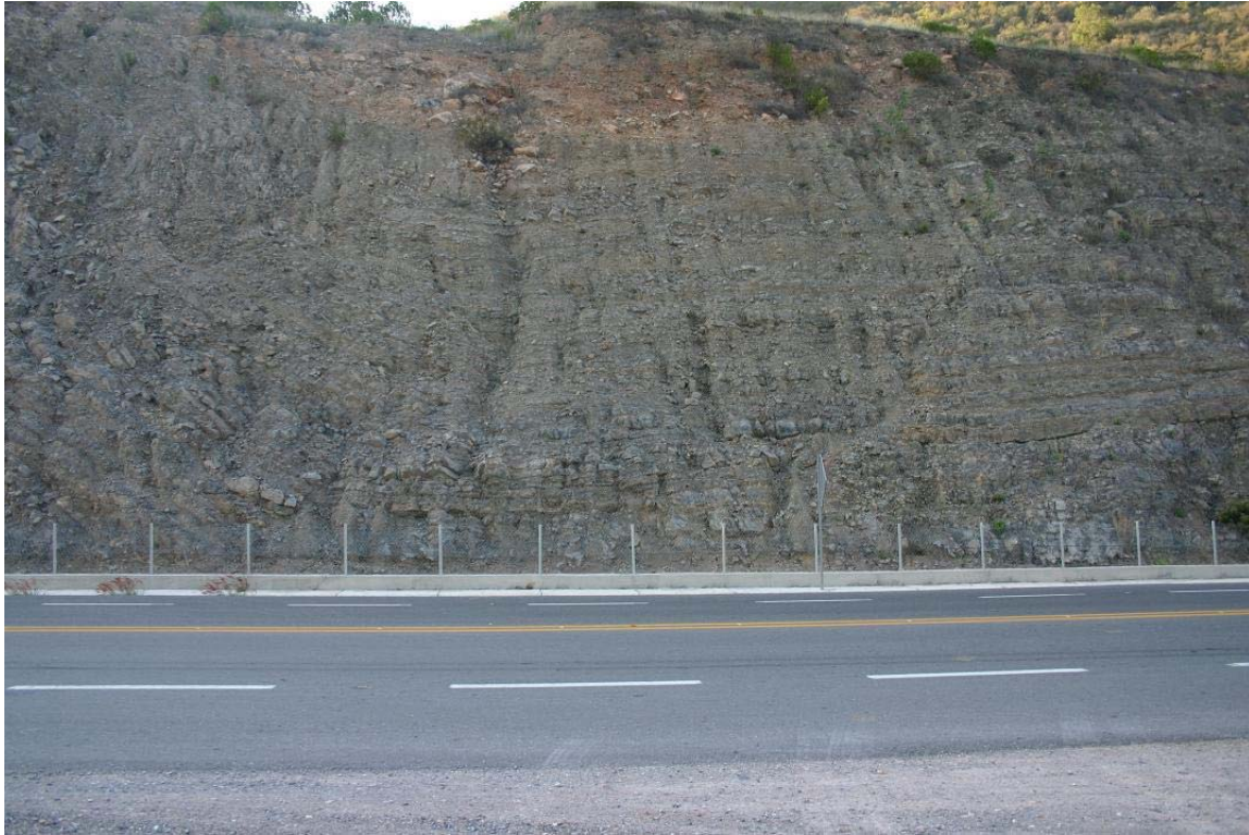
Fotografía 15. Material intemperizado, con pérdida de material cohesivo y con mucha porosidad.
