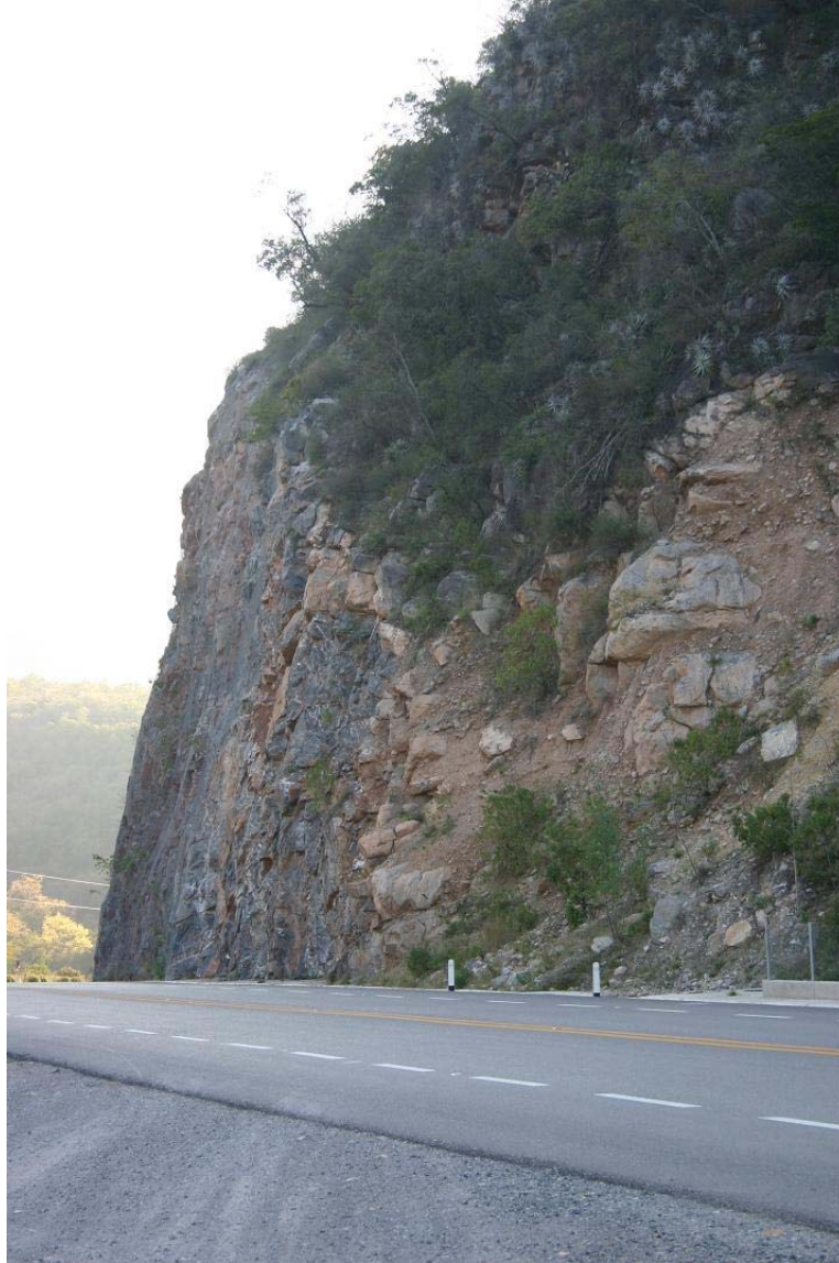
Fotografía 17. Corte con pendiente pronunciada y roca suelta.
