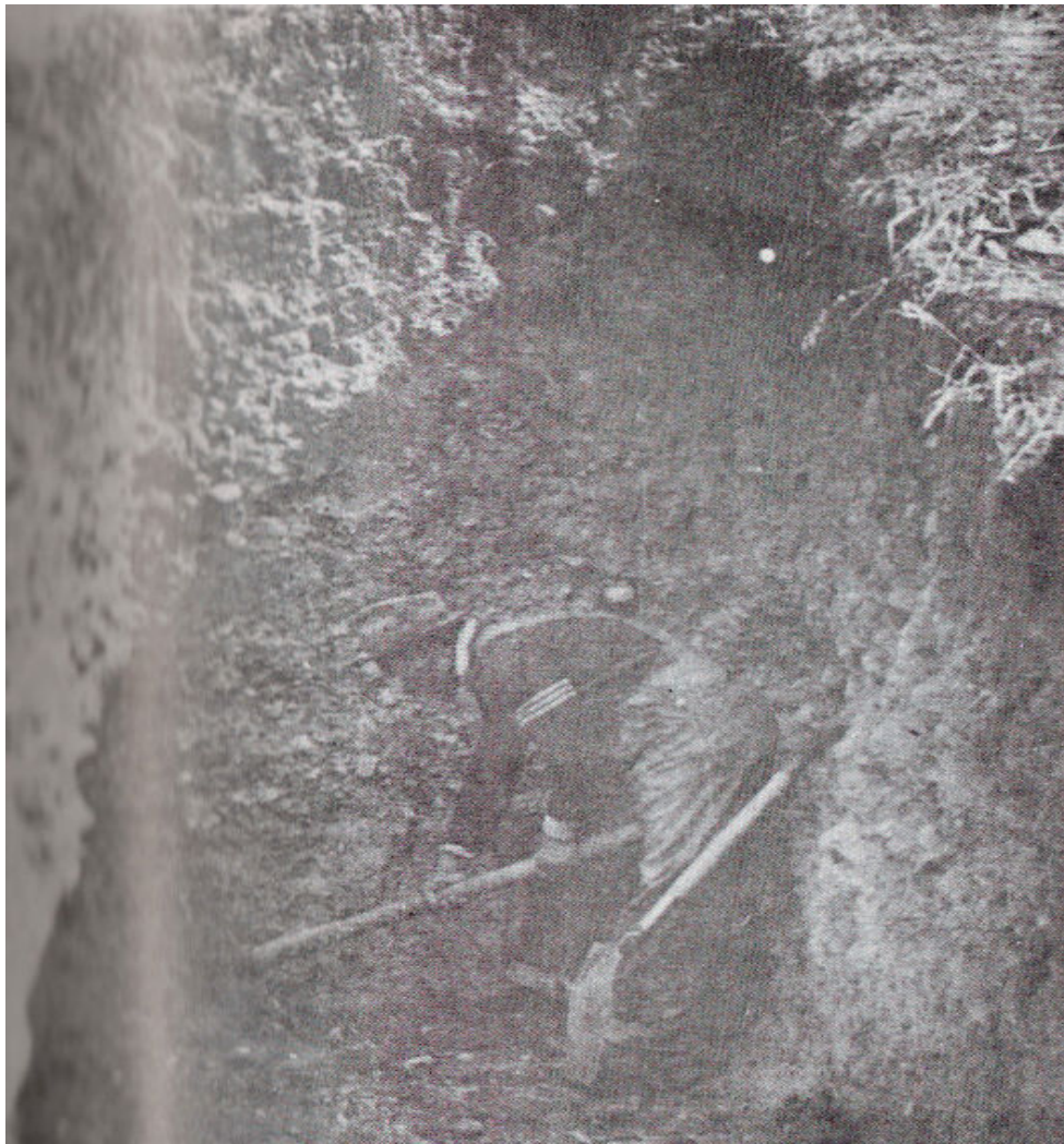
Fig 7.1 características del sondeo para la obtención de muestras alteradas e inalteradas mediante la excavación de un pozo a cielo abierto
