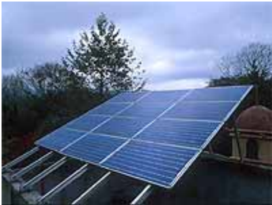
Uso de Energía Solar
