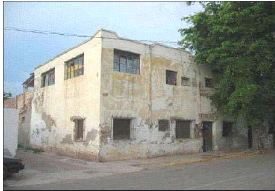
VISTA DE CONSTRUCCION DEL TIPO ANTIGUA MAL CONSERVADA.
