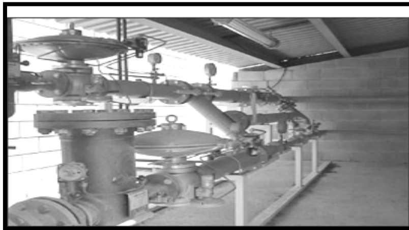
Figura 5.6 Vista de la instalación interna en una empresa.
