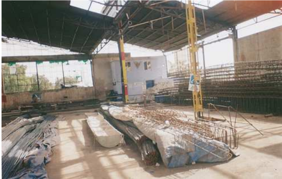
Fig. VI. 3 Almacén de acero
