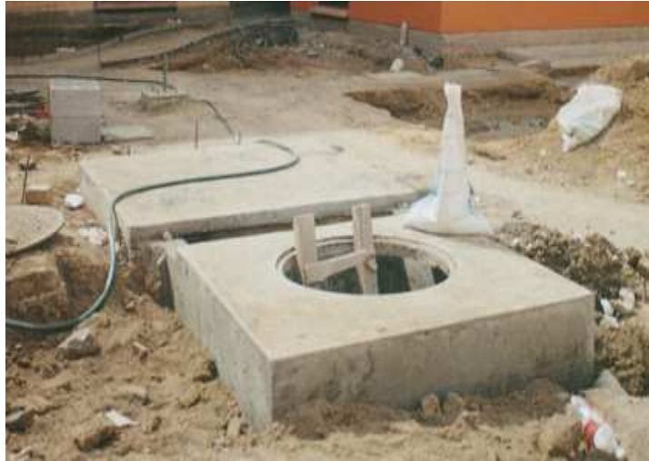
Fig. IV.26 vista superior de registro eléctrico
