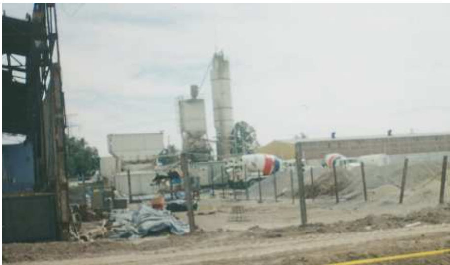
Fig. VI.7 Planta de concreto instalada
