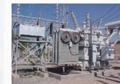
Subestación eléctrica 115/13.8 kV
