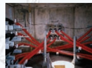
Acomodo de cables en registro de empalmes
