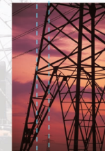
Torre de transmisión
