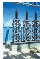
Terminales y soportaría para 34.5 kV, en subestación eléctrica
