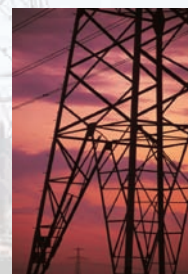
Torre de transmisión
