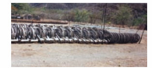
Poleas triples para tendido de conductor
