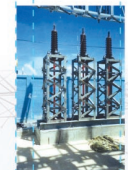
Terminales y soportorio para 34.5 kV, en subestación eléctrica
