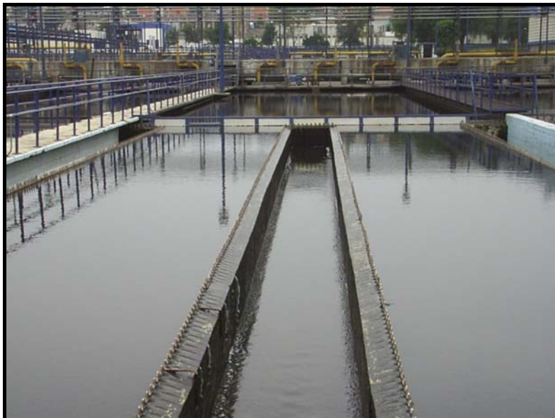
Figura 4. Estación 3. Tanque Sedimentador Secundario
