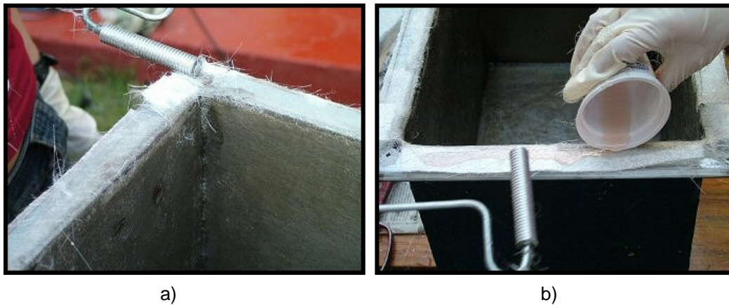
Figura 4.7 a) Colocación de la fibra de vidrio en la pestaña del tanque; b) Adhesión de la resina en la pestaña.
