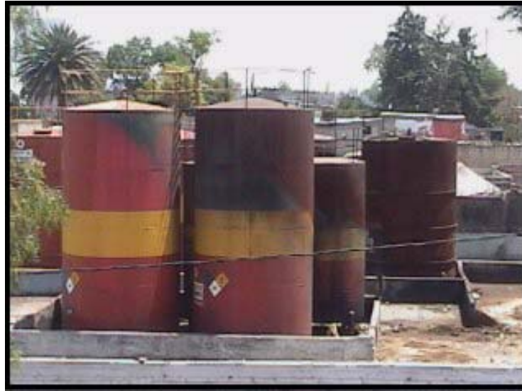
Figura 1.1 Contenedores de combustible atacados por la corrosión.
