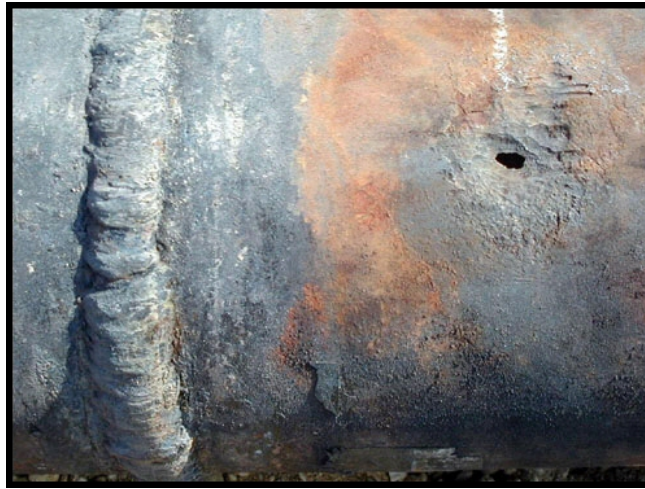
Figura 1.5 Corrosión por picadura en una tubería. [5]
