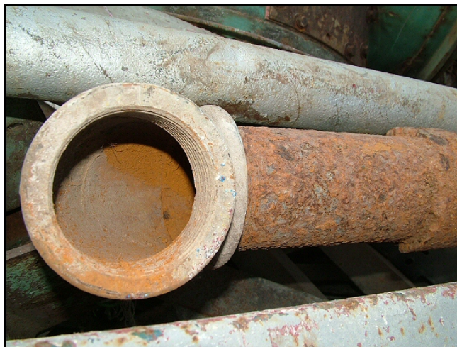
Figura 1.6 Tubería que presenta corrosión-erosión interior.
