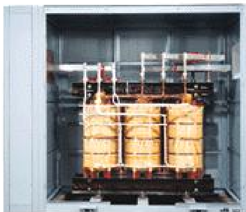
Figura V.I.28 Transformador de aislamiento
