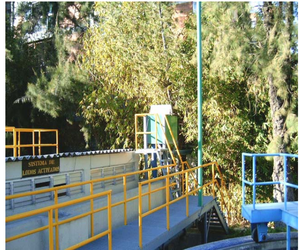
Fotografía 2. Caja partidora de lodos en la PTARCU.
