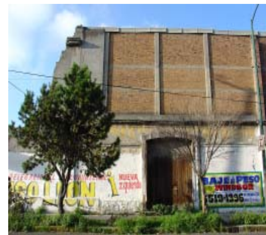
Varias vistas del deterioro del terreno.
