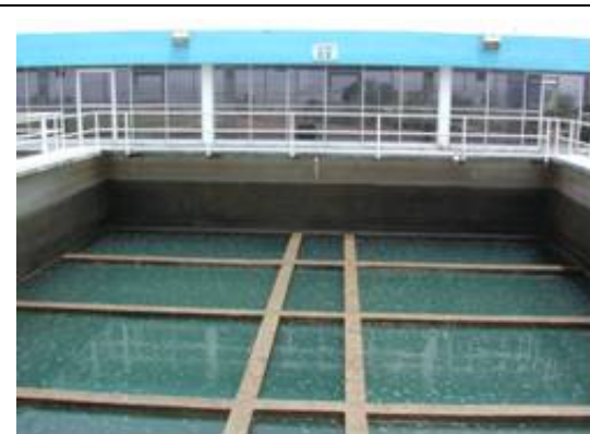
FOTO E.6 SECCIÓN DE FILTRACIÓN
