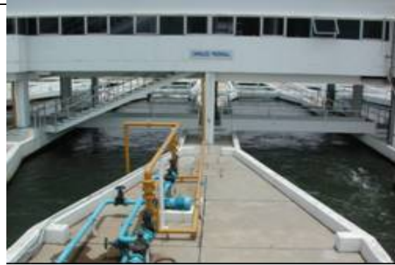
FOTO E.2 CANALES PARSHALL
