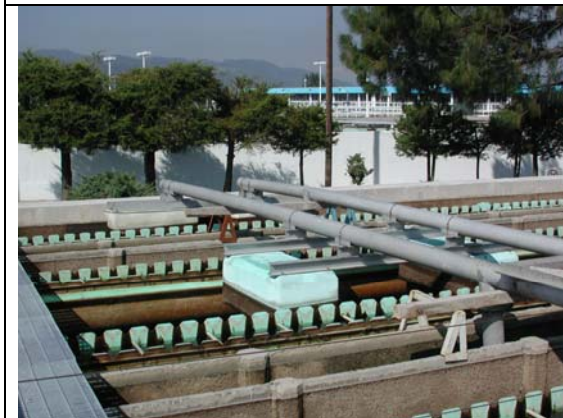
FOTO E.5 SISTEMA CLARIVAC
