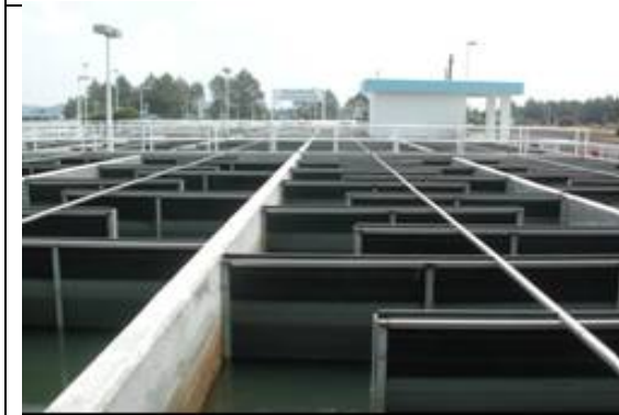
FOTO E.3 SECCIÓN DE FLOCULACIÓN
