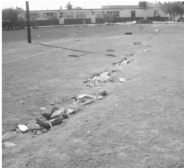
Fig.28. Grieta asociada a subsidencia del terreno, su longitud es de 300 m aproximados, presenta una anchura entre 30 y 60 cm y su profundidad visible es de 60 cm. Los daños han sido severos en la Escuela Primaria Federal Rafael Ramírez, ubicada en la calle de Holanda esquina con México. La fotografía muestra los rellenos como medida de mitigación, este proceder en la mayoría de los casos favorece el crecimiento de las grietas.
