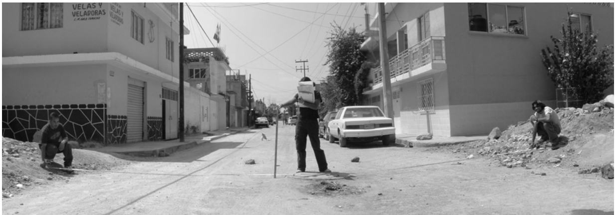
Fig. 25. Acumulación de material en ambos flancos de la calle M. Ávila Camacho y Miguel Alemán (Col. Filiberto Gómez), con el fin de elevar el nivel de los terrenos y evitar las inundaciones estacionales.
