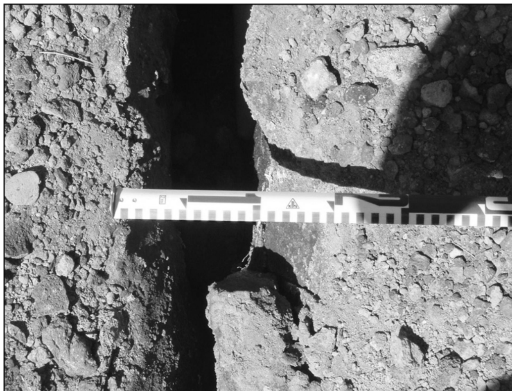
Fig. 16. Grieta ubicada en la Escuela Artes y Oficios, la anchura es de 12 cm y la profundidad varía entre 15 cm y 1m.
