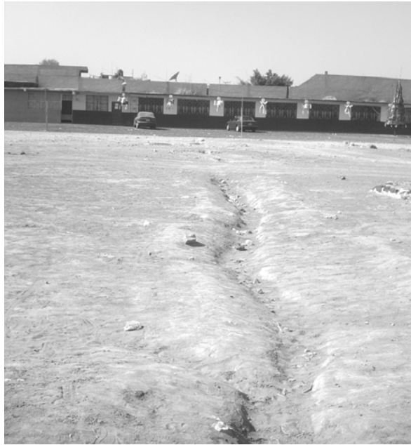
Fig. 27 Grieta cuya génesis se asocia a hundimientos del terreno provocados por la sobre explotación de los mantos acuíferos. El ejemplo que se muestra se localiza entre Avenida Organización Popular y Yacatlí; con 30 m de longitud y 46cm e ancho, la profundidad visible es de 15 cm. promedio.
