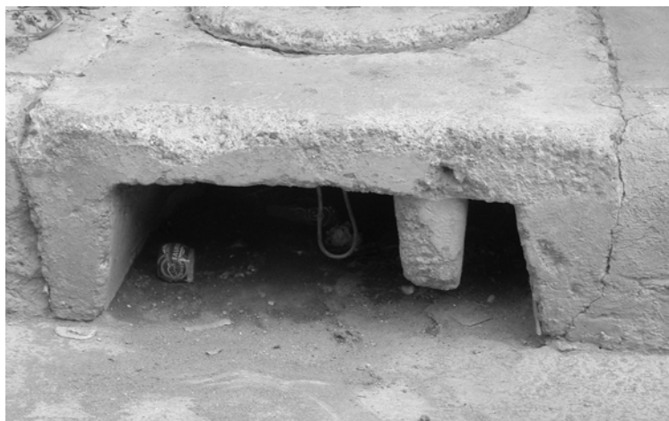
Fig. 22. Coladera azolvada por detritos y basura; calle Ignacio Allende, Col. Filiberto Gómez.
