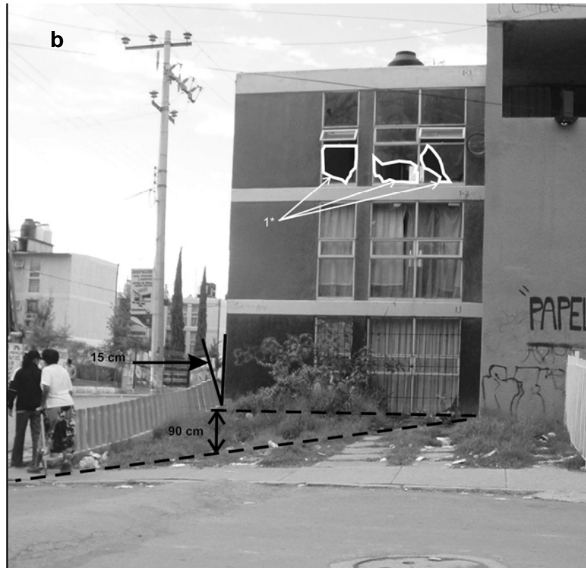
Fig. 17. Ejemplos relacionados con la dinámica de las grietas: a) Hundimiento del terreno sobre la Avenida el Molino en el fraccionamiento del mismo nombre. b) Desplome y deformación de las paredes del edificio; el movimiento diferencial ha descuadrado las ventanas y roto los cristales.
