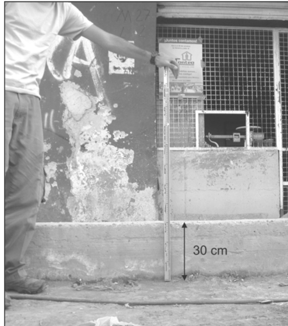
Fig. 24. Pequeño muro de contención construido como una medida de mitigación para las inundaciones estacionales. La foto fue tomada en la calle Juan de la Barrera, Colonia Villa San Lorenzo Chimalco.
