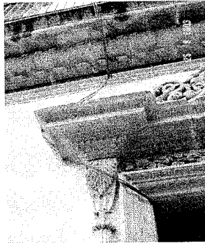
Imagen 26. Instalación eléctrica adosada a fachada
