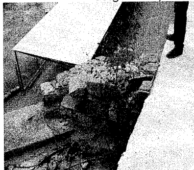
Imagen 53. Muro inconcluso y con flora nociva en colindancia azotea
