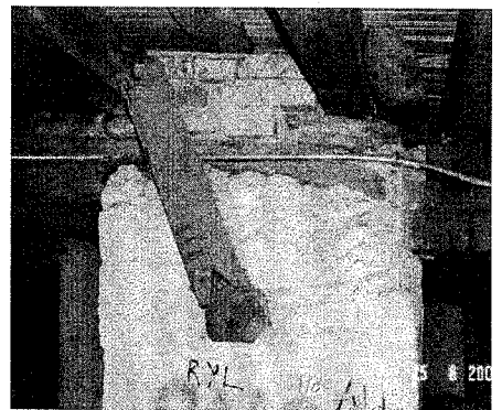
Imagen 48. puntales improvisados en sótano para sostener piso escenario
