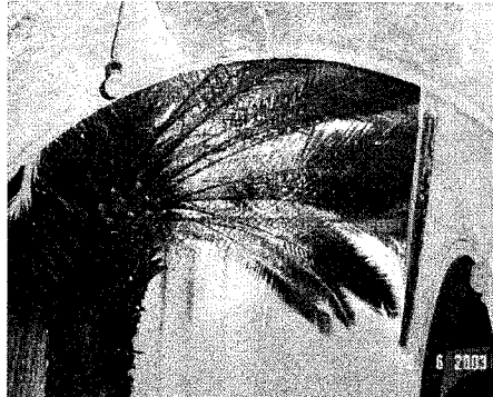
Imagen 38. Palmera adosada a muro de fachada lateral
