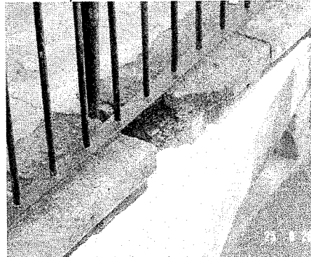
Imagen 35. Pieza faltante en cornisa pasillo primer nivel
