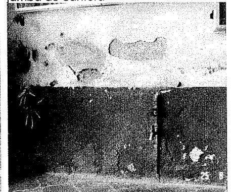
Imagen 36. Humedad en muro y desprendimiento de aplanado en muro pórtico planta baja
