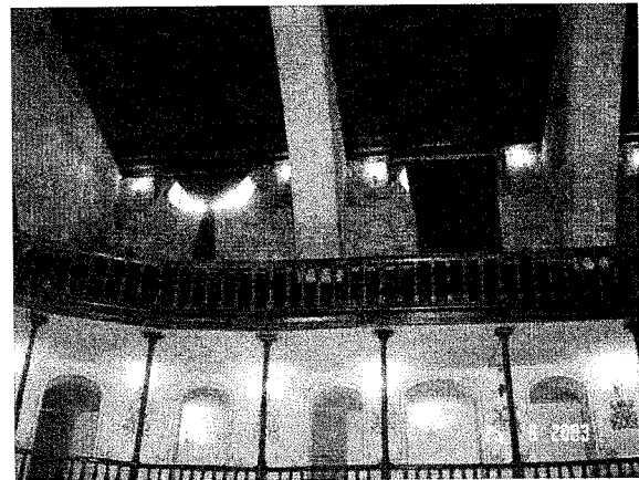
Imagen 24. Observar plafones de cielo raso en palcos y decorados más sencillos en los muros enlucidos. Observar también la cubierta aparente que descansa sobre estos grandes arcos de mampostería.
