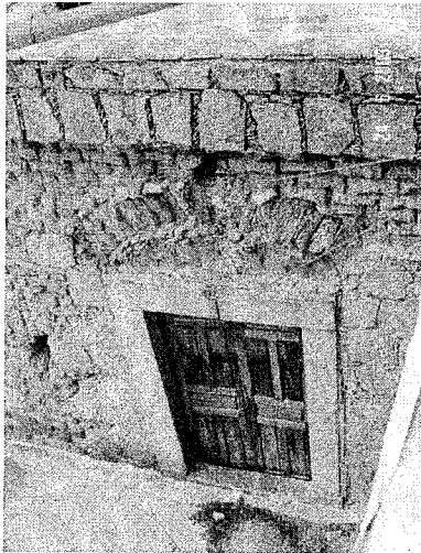
Imagen 19. Esta fotografía corresponde al teatro Hinojosa se puede observar que tiene algunos muros de adobe con arcos de descarga, porque estructuralmente el dintel no es suficiente para librar el vano, ya que no es un diseño correcto para la función que se pretende, pues no está dovelado y por tanto no cuenta con piedra clave.
