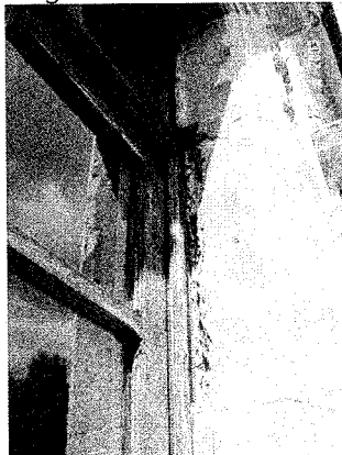
Imagen 32. Desgaste de jambas de cantera y rellenos de cemento
