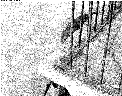
Imagen 34. Balcón desnivelado con contrapendiente y gárgola improvisada
