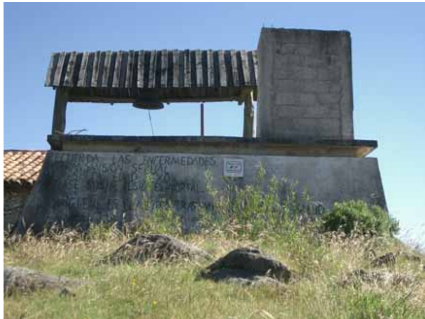
Ilustración 5. Depósito de agua de la comunidad
