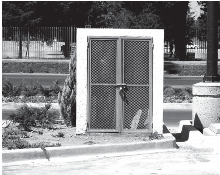
Foto III.4.4.10 Gabinete de mampostería del tablero de control.
