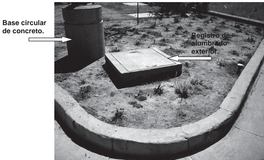
Foto III.5.3.1 Base de poste de alumbrado y registro.
