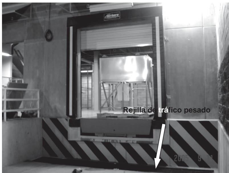
Foto III.4.3.3 Registro pluvial en anden de carga.
