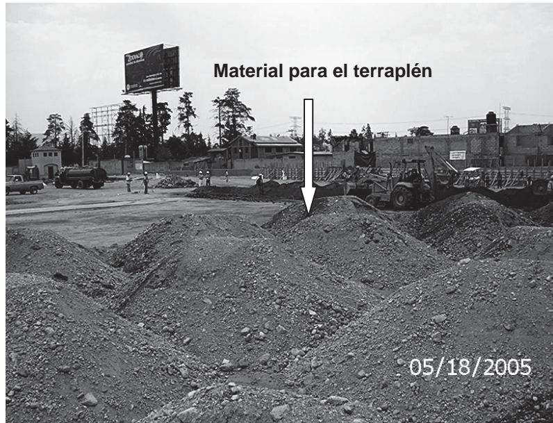
Foto III.2.2.5 Se aprecia la separación de los viajes del material para el relleno.
