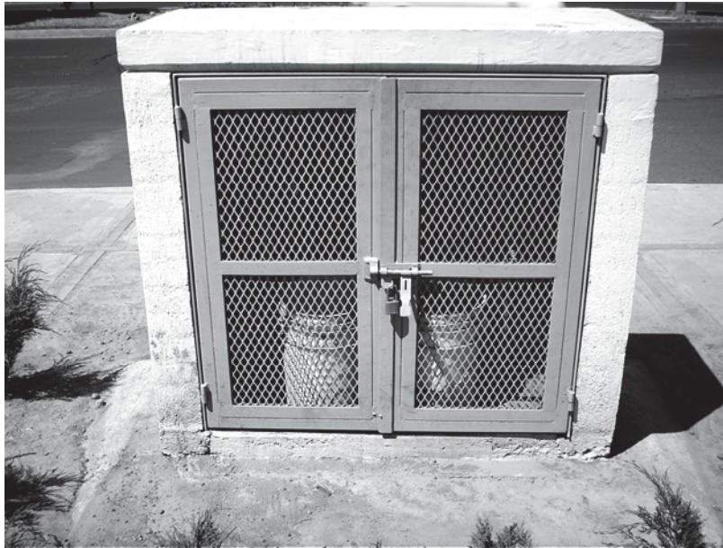
Foto. III.4.1.3 Gabinete del cuadro de acometida terminado.
