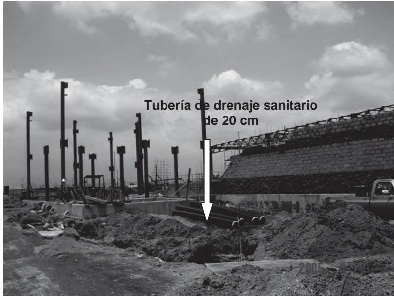
Foto. III.4.2.1 Tubería de polietileno corrugado.
