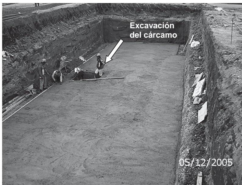
Foto III.4.4.3 Cárcamo de bombeo.
