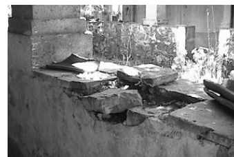
F.17 Piezas rotas en cerramiento de murete, desprendimiento de aplanado.
