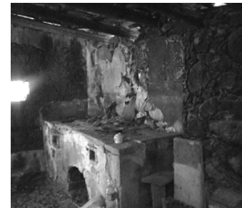
F.09 desprendimiento de aplanado, pintura mural afectada, hollín en muro.
