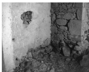
F.14 Oquedad en muro, pintura mural dañada, faltante en piso, disgregación de material en base de muro, nivel original de piso modificado.
