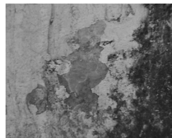
F.18 Pintura mural dañada por presencia de musgo. Pintura mural sobrepuesta.
