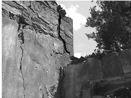
En la imagen se aprecia una de las grietas en la fachada nororiental, que evidencia la tendencia al desprendimiento de la fachada.
