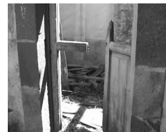
F.19 Puerta quemada incompleta.
