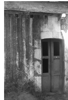
F.08 Puerta incompleta (faltan cuarterones), Enmarcamiento dañado. Humedad y musgo en muro
