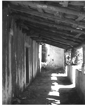
F.01 Humedad en muro y falta de piso
