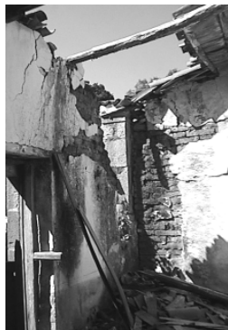
F.03 Colapso de cubierta, desprendimiento de aplanado, escombros producto del colapso.
