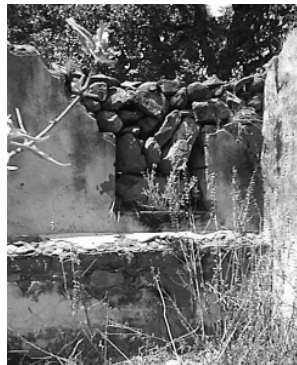
F.22. Vano tapiado, colapso cubierta, falta de aplanado.
