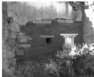
F.11 Desprendimiento de aplanado. Juntas erosionadas.
