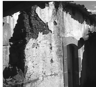
F.02 Colapso de muro, humedad en muro, desprendimiento de aplanado, disgregación de material.
