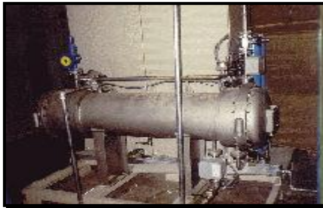
FIGURA 12. Generador de ozono
