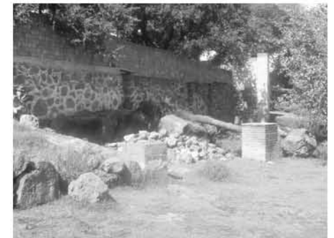
Foto 12. Pozo de visita en vialidad de terracería
