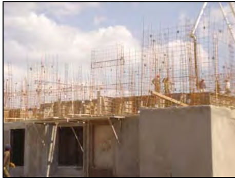
Fig. 5.6 Continuidad en 2do nivel de la malla de refuerzo en muros de concreto
