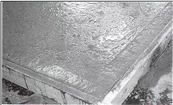
Fig. 1.15 Agua de sangrado en la superficie de concreto recién colado en la losa
