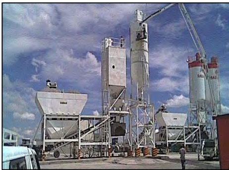
Fig. 3.1 Planta de fabricación de concreto
