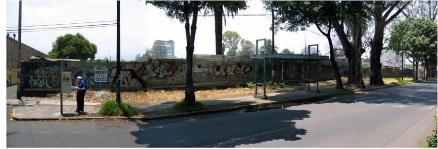
VP2. Vista panorámica del perímetro norte, se observa el notable deterioro de la misma y su abundante vegetación
