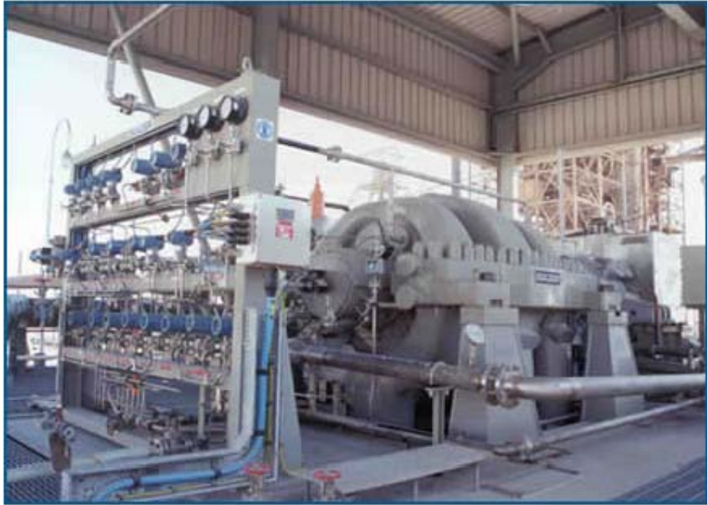
Figura 4.1 Compresor de gas húmedo de la FCC de BAPCO (Bahrain Petroleum Company) 11
